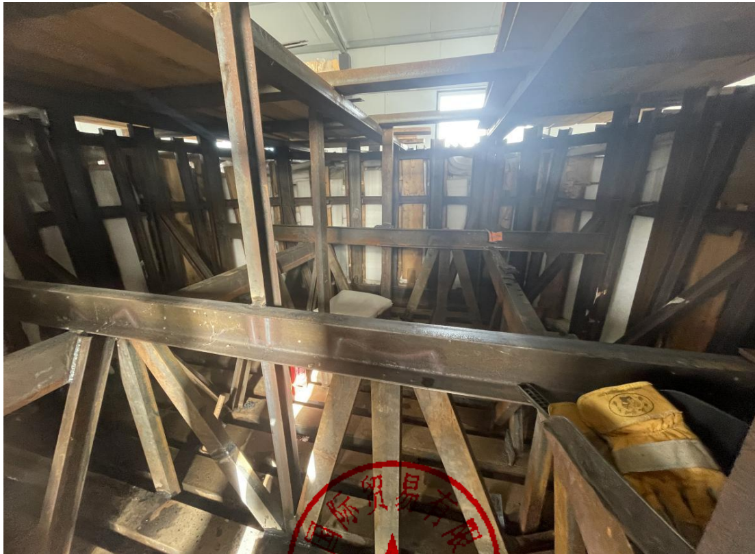
内部钢结构保护支护现状
