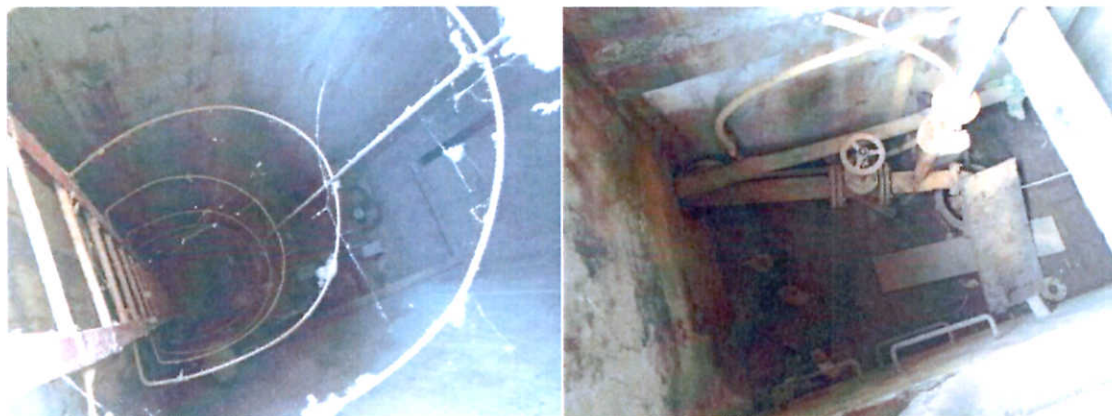
橡胶坝充泄水设备
